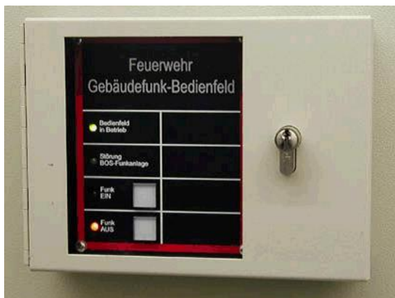
Abb. 60 Bedienfeld Gebäudefunkanlage [Feuerwehr Dortmund]
